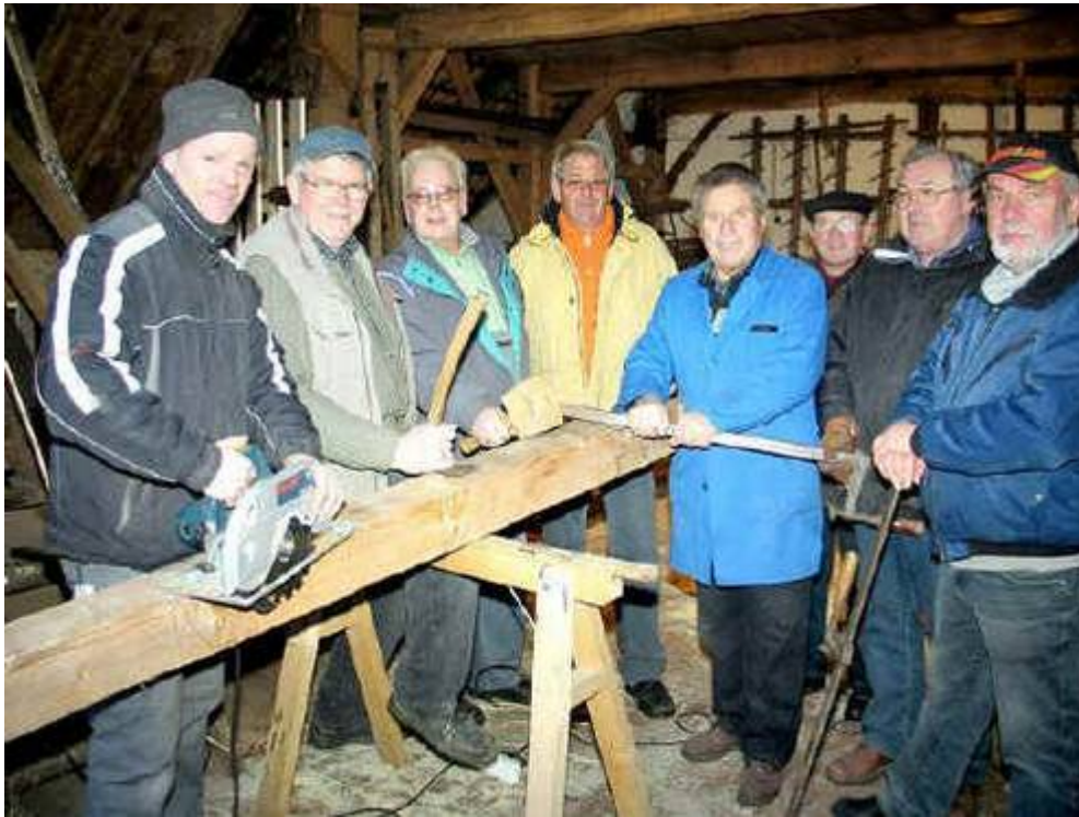
Mit der Säge wird die Fußfette für die Brauhaus-Erweiterung fachmännisch bearbeitet. Jeden Dienstag treffen sich die Handwerker um Alfons Haar (2.v.l.) auf dem Museumshof, um das Projekt voranzutreiben. (Foto: Jürgen Schroer)
